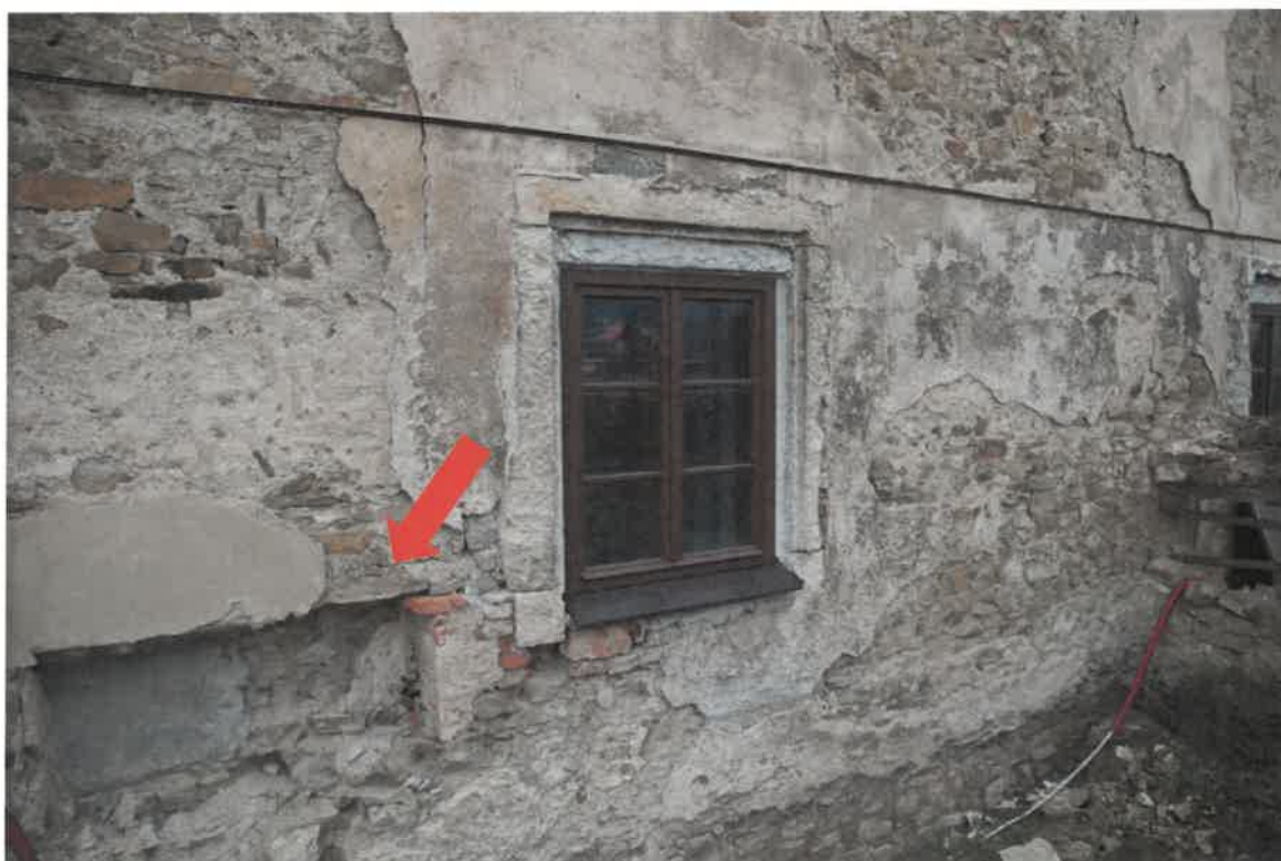
Foto 02 – detail severní fasády objektu – nutné vyspravení
