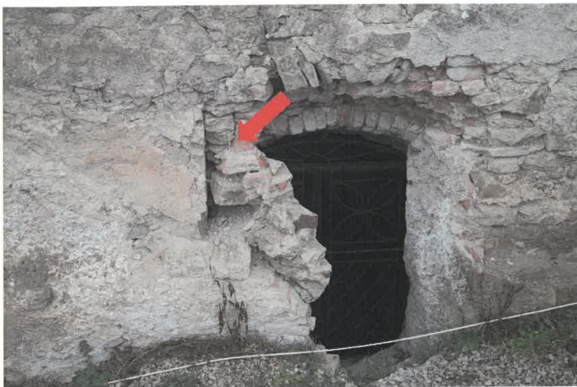
Foto 05 – detail východní fasády objektu – nutné vyspravení
